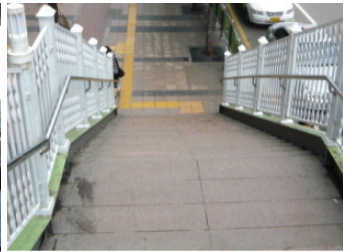
동일 재료로 마감되어 식별이 어려운 계단 디딤판
