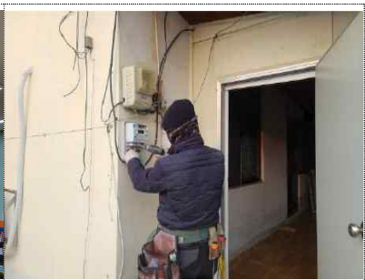
개별 전력량계 설치
